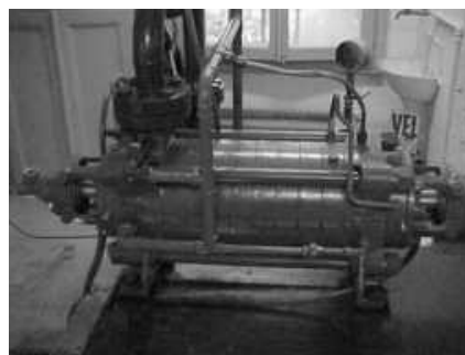
Une des pompes qui envoie l'eau à Saint-Cergue
